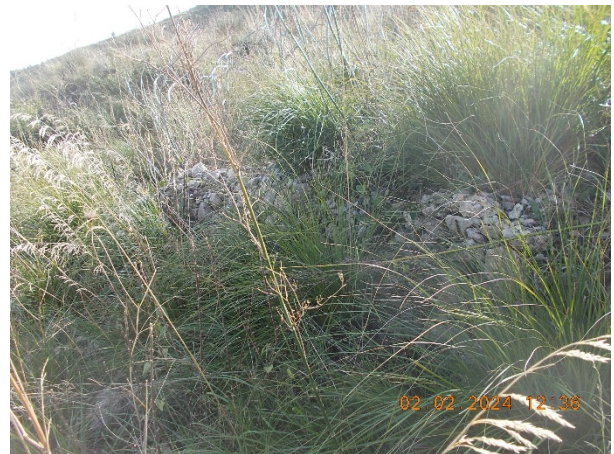
Foto dei ruderi di muro a secco dei terrazzamenti, strutture molto utili nel passato per la semina sui pendii collinari. Oggi i terrazzamenti sono in abbandono, nascosti dalla vegetazione e in pericolo di crollo
