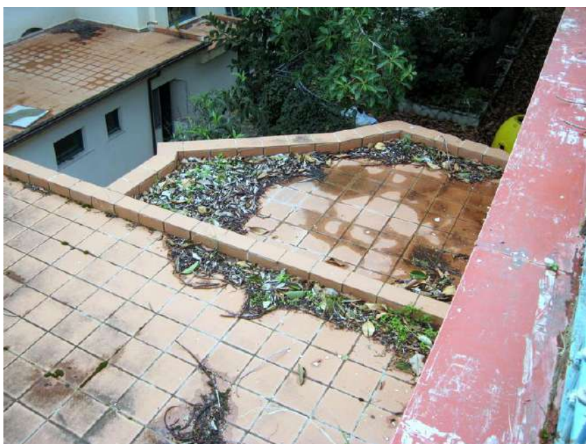
Foto n. 197. La maldestra collocazione delle lastre in marmo che fanno da contorno ai balconi procura la facile infiltrazione dell'acqua piovana anche al di sotto di essi.
