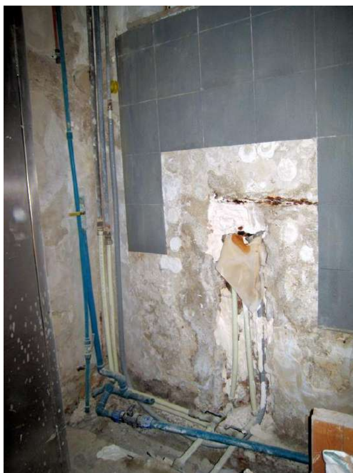
Foto n. 25. Le condizioni in cui versano rivestimenti ed impianti a fine corridoio.
