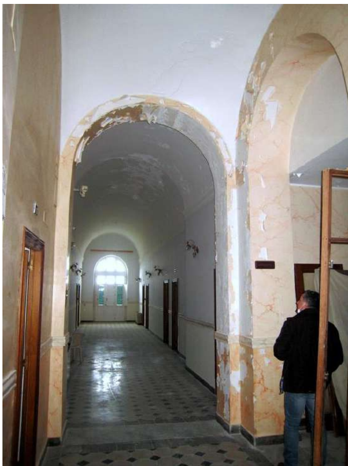
Foto n. 106. Corridoio lato Nord. Tracce di umidità pregressa.
