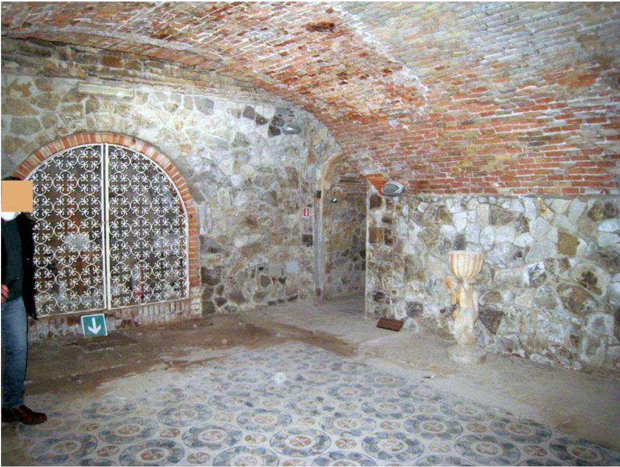
Foto n. 16. La sala di disimpegno al piano interrato dove, dietro il cancello, c'è la sorgente delle acque termali.
