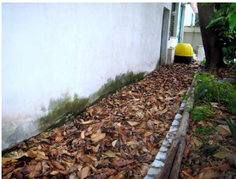
Foto n. 137. Umidità di risalita nei locali tecnici. Il giardino non viene pulito da tanto tempo.
