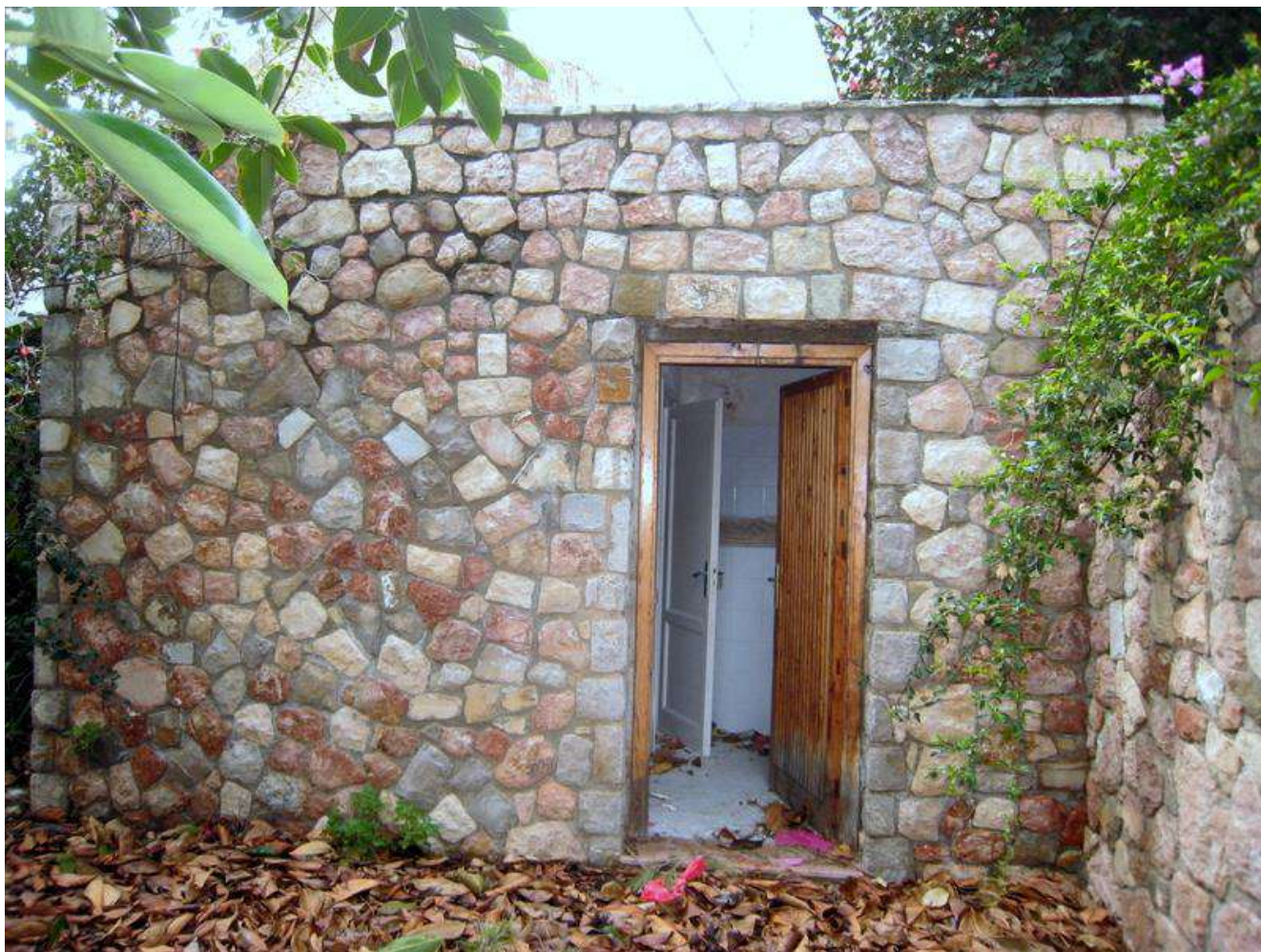
Foto n. 164. Il corpo dei bagni è distaccato dalla piscina ed interamente rivestito con pietra. La copertura piana fa acqua che si riversa all’interno.
