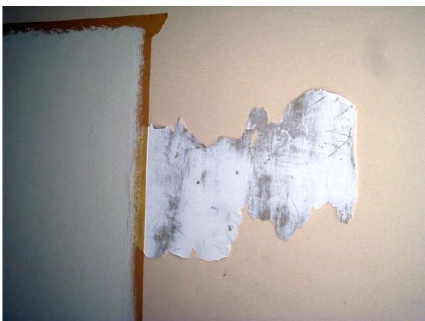
Foto n. 71. Esfoliazione della pittura
