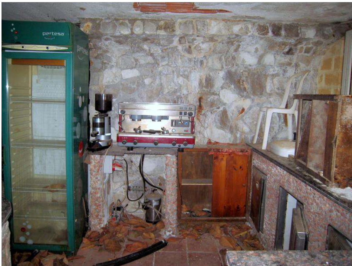
Foto n. 168. Il piccolo locale impropriamente utilizzato come Bar atteso che la sua altezza è di soli di metri 2,35, non compatibile con nessun uso che prevede la permanenza dell'uomo. Si configura, dunque, come un locale tecnico accessorio alla piscina.
