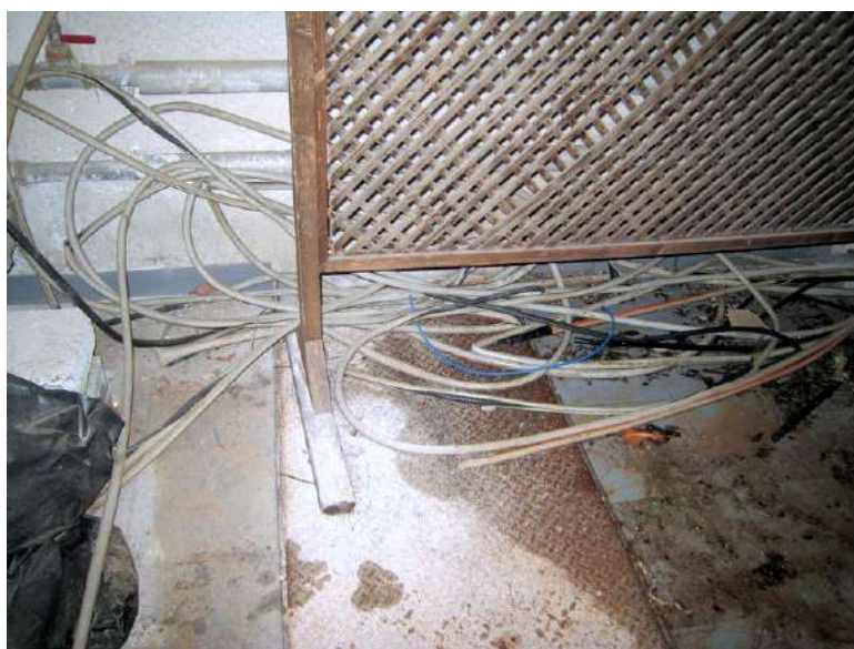
Foto n. 187. A terra i resti dei cavi privi del rame.
