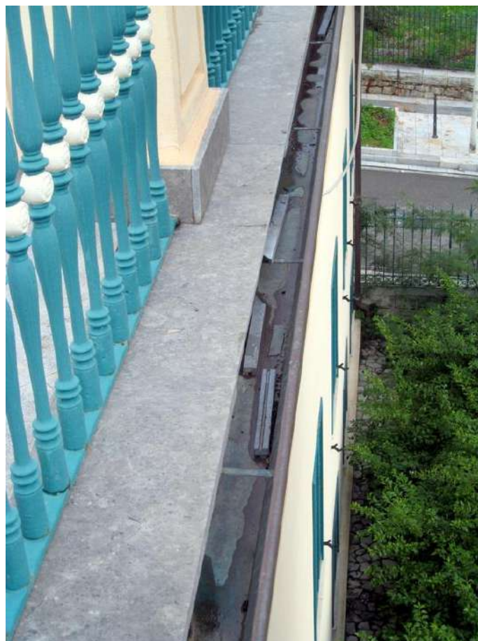
Foto n. 200. Tutte le lastrette di marmo stanno cadendo provocando l'otturazione delle gronde.
