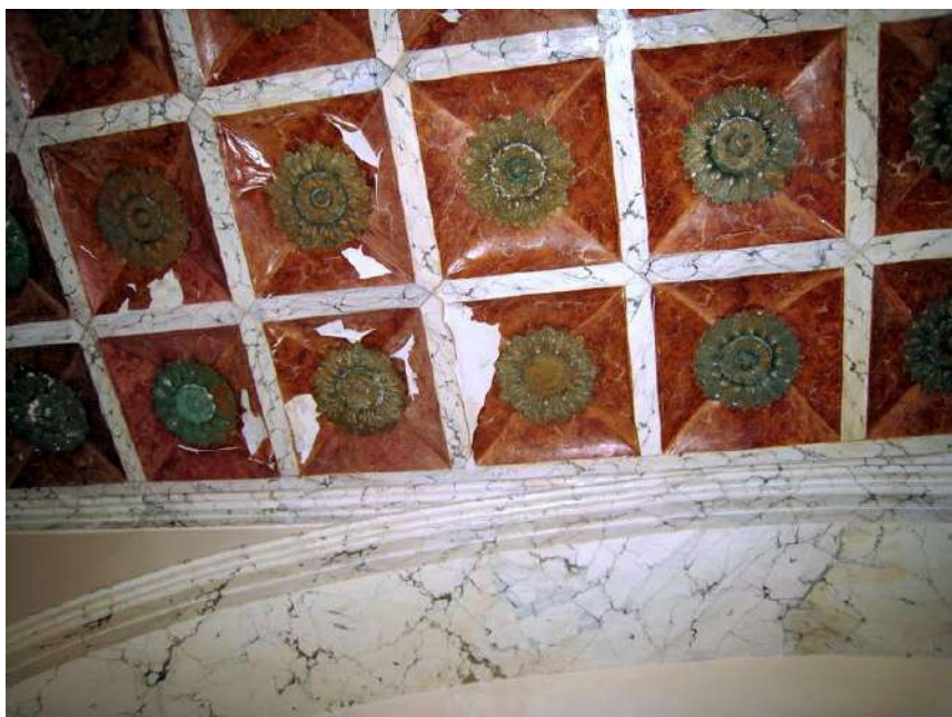
Foto n. 70. Le condizioni dei cassettoni
