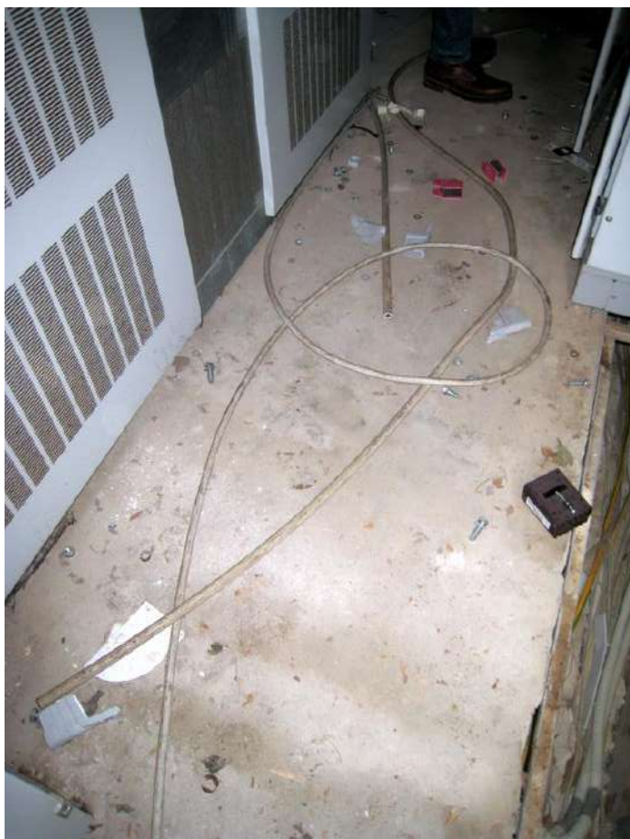
Foto n. 175. Cavi a terra privi del rame.
