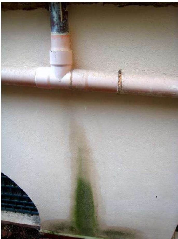
Foto n. 199. Un tubo pluviale proveniente dal terrazzo perde e danneggia gli intonaci sul retro.
