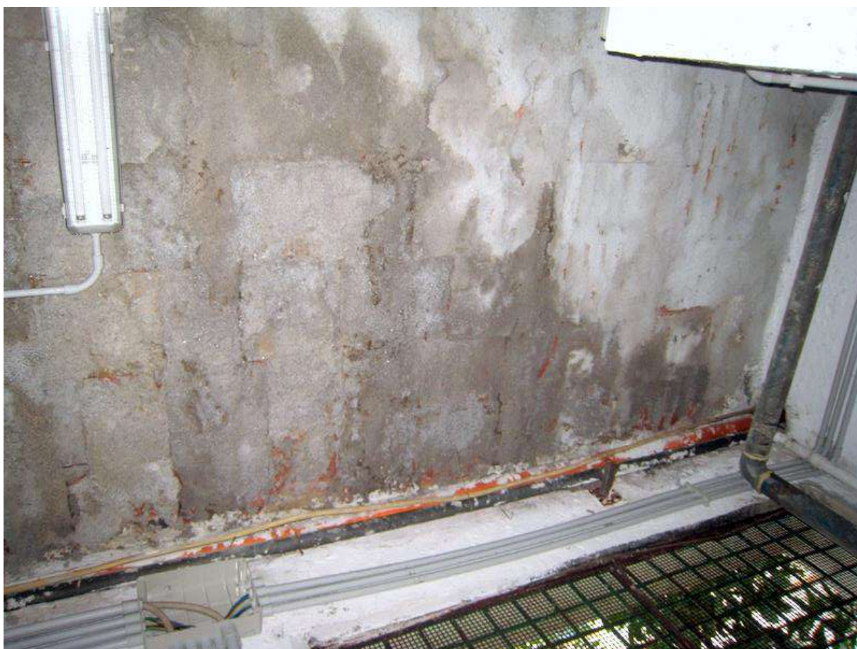
Foto n. 190. Il tetto è totalmente intriso d'acqua proveniente dal solaio-terrazzo a livello soprastante.
