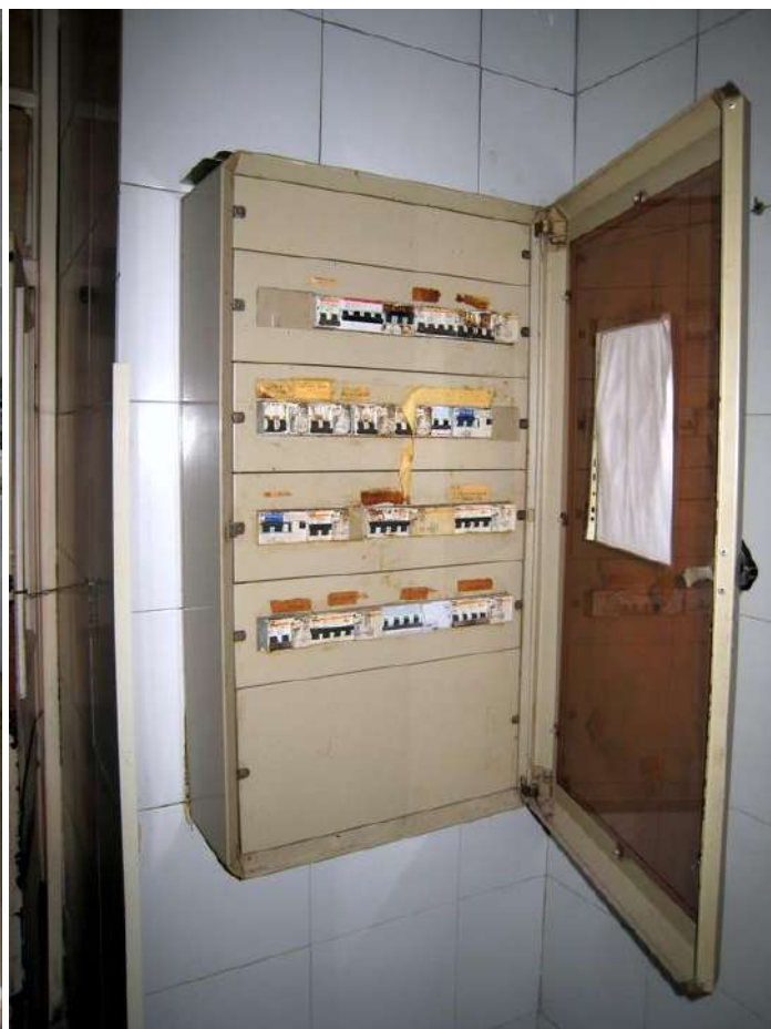
Foto n. 57. Quadro elettrico della cucina.
