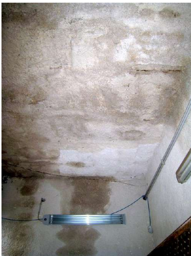
Foto n. 186. Il solaio è imbibito d'acqua.
